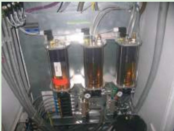
6 pompe per lubrificazione esterna 4 pompe per lubrificazione interna
