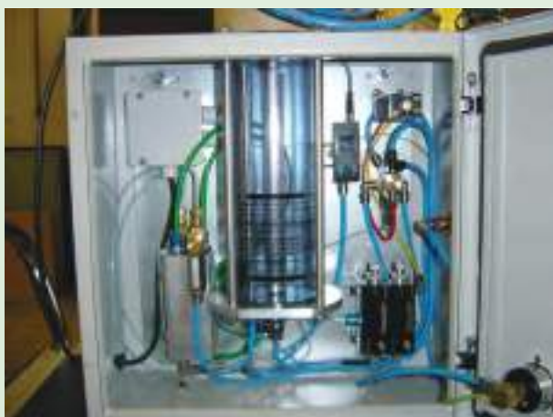
2 pompe per lubrificazione interna
